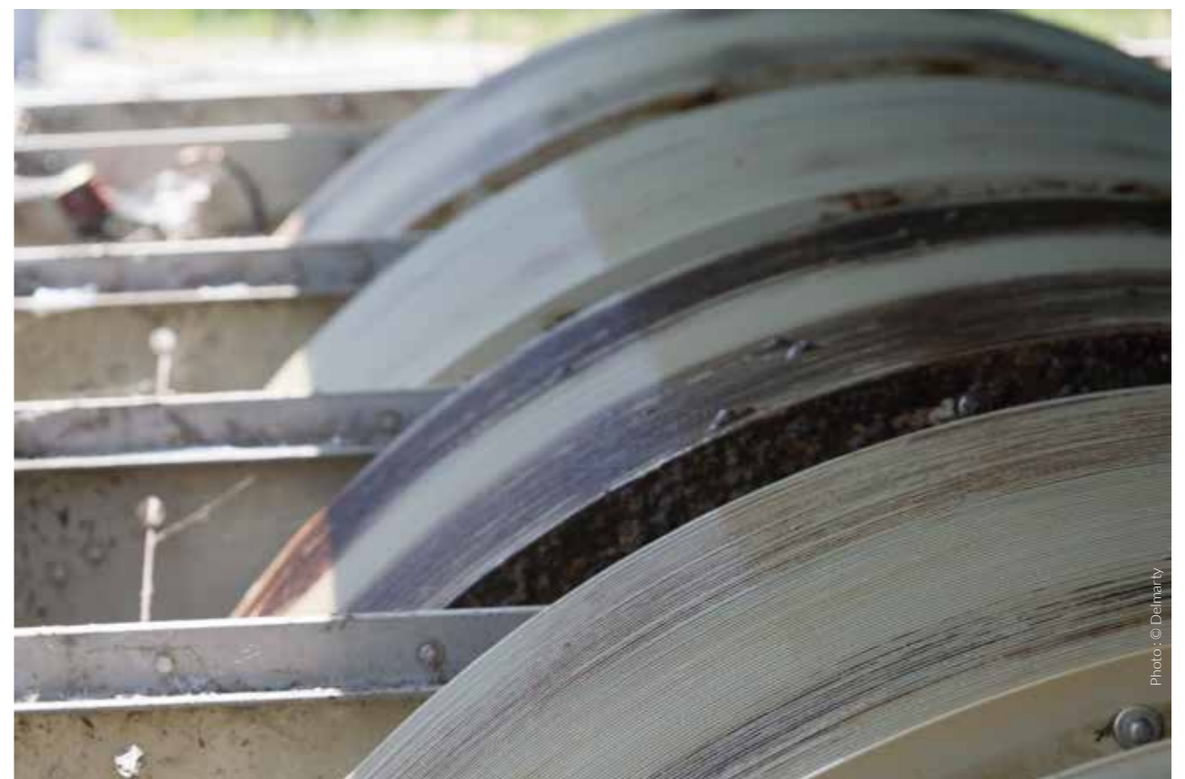
Biodisques, station de traitement des eaux usées de Barbières
