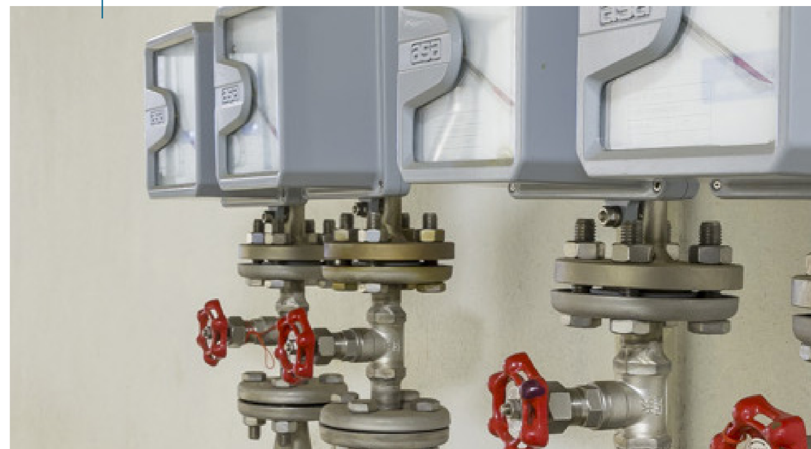
Capteurs, usine de production de Mauboule à Valence
